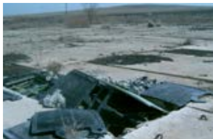
Хранилище для ЖРО со следами раскопок, вид до ремонта
