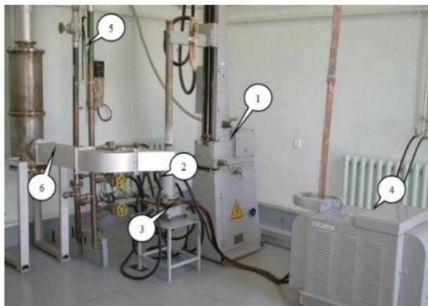
1 – электрошлаковая печь; 2 – кристаллизатор; 3 – поддон; 4 – трансформатор; 5 – система водяного охлаждения и сбора сточных вод; 6 – система автономной вентиляции
