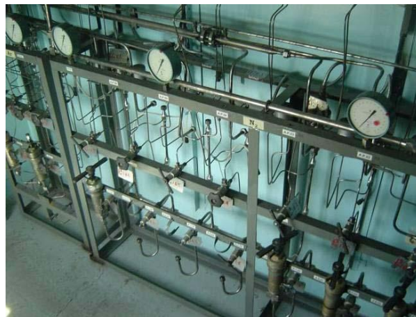
Рисунок 1. Агрегатный шкаф системы подачи инертных газов
